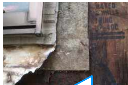
雨水が長時間入り込んでいると下地が腐ってしまう状態に…
